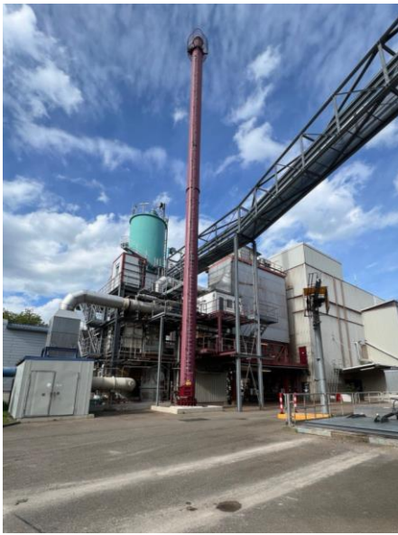
м.Карлсруе (котельня із спалювання мулу)
