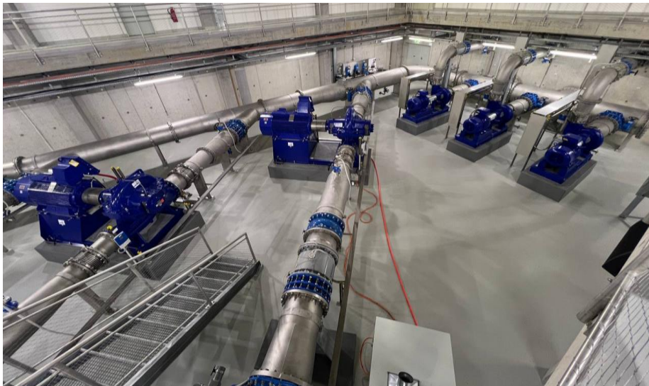
м. Мюнстер (водоочисна та водопровідна станція)
